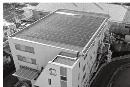
社屋屋上の太陽光パネル
